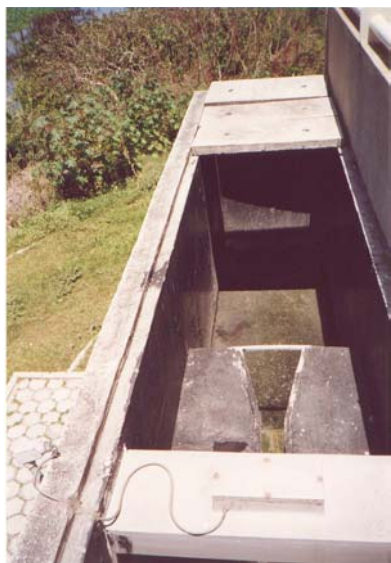
Fotografia 05 – Efluente na calha parshall, sendo encaminhado para o corpo receptor.
